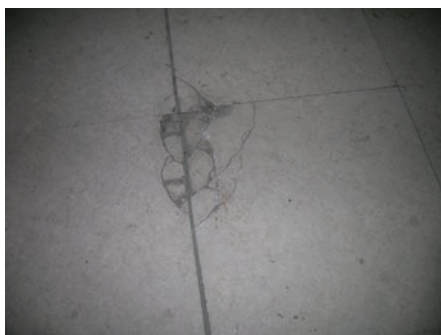
Afb. 12 Schade langs een verdeelvoeg.
