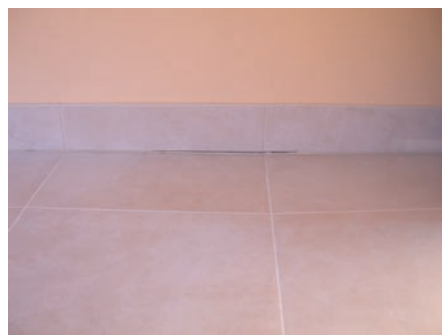
Afb. 14 Open voeg tussen de plint en de betegeling.
