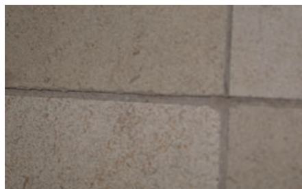
Afb. 2 Optreden van scheuren in de voegen.
