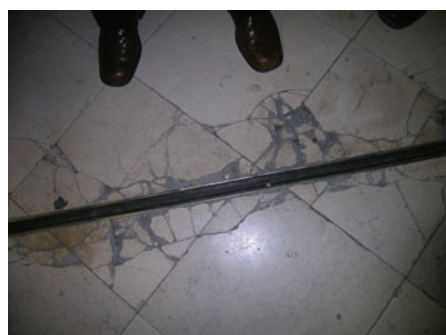
Afb. 11 Schade in de buurt van een uitzettingsvoeg.
