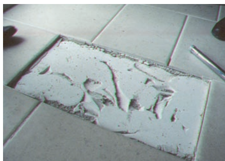
Afb. 5 Onthechting tussen de legmortel en de betegeling.
