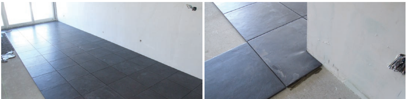
Afb. 17 Om vlotter te werken, snijdt men vaak verkeerdelijk de plintopstanden van de elastische tussenlaag af vóór men de vloerbekleding aanbrengt. De contacten tussen de betegeling en de muren of de contacten die gevormd worden door de voegen tussen de betegeling en de muur, kunnen in dit geval de zwevende dekvloer kortsluiten, waardoor de contactgeluidsisolatie met meer dan 15 dB kan afnemen en men van een opstelling die voldoet aan de criteria uit de norm, overgaat naar een zeer oncomfortabele situatie.
