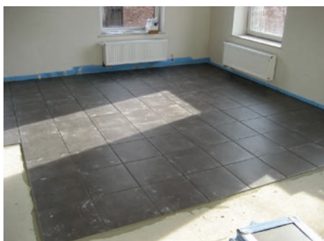
Afb. 12 De plintopstand van de tussenlaag blijft zichtbaar bij de plaatsing van de betegeling en het opvoegen.
