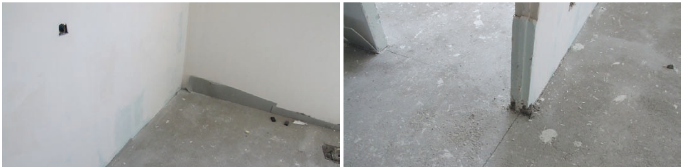
Afb. 16 Indien de randstrook niet meer zichtbaar is bij de plaatsing van de vloerbekleding, is het erg waarschijnlijk dat er zich reeds flankerende akoestische bruggen gevormd hebben tussen de dekvloer en de muren. Men kan in dit stadium de efficiëntie van de zwevende dekvloer controleren door de isolatie ter plaatse te meten. Indien men echter een slecht resultaat bekommt, is het bijna onmogelijk om de isolatie alsnog te verbeteren zonder de dekvloer uit te breken.
